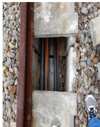
96 芯光纖電纜及線槽
