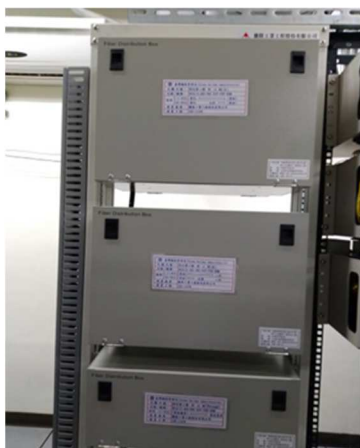
96 芯光纖機房投落
