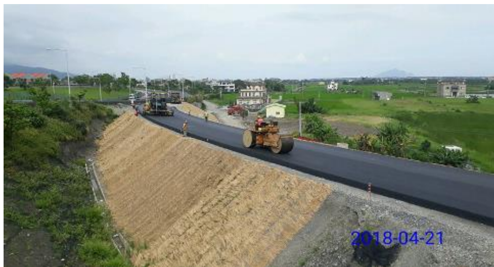
第 E14 標 匝道 L1 路堤段瀝青處理底層及密級配瀝青混凝土鋪築
