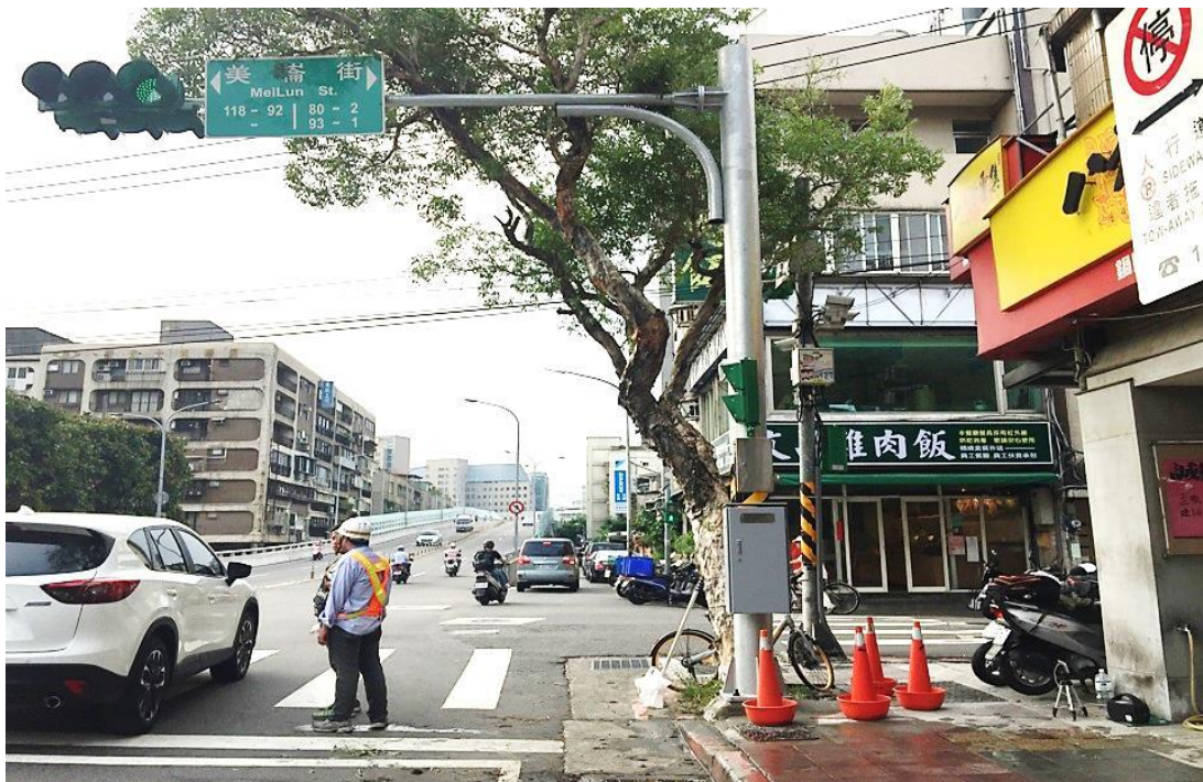
圖 4 文昌街美崙街口縮小型控制器(施工後)
