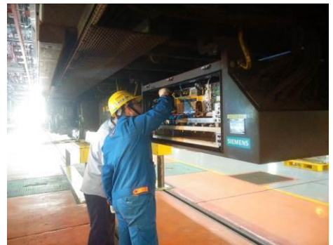
牽引換流器檢修
