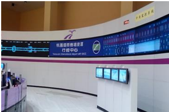
中央監控系統工程
