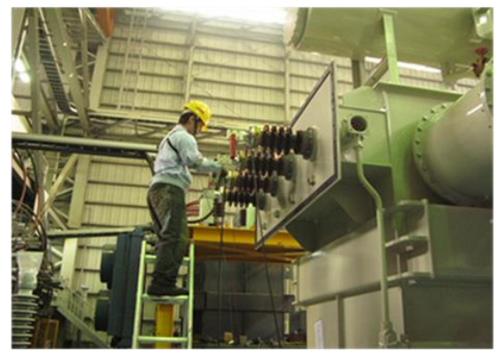
主變電站變壓器工廠測試(2)
