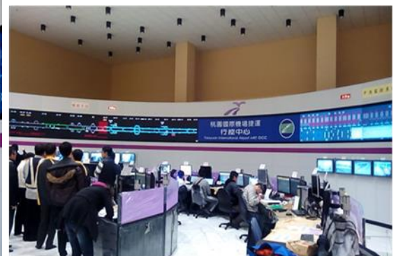
中央監控系統工程
