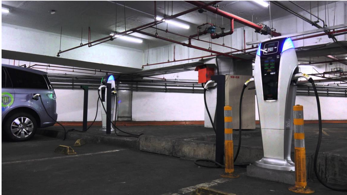
圖 13 停車場電動車充電站
