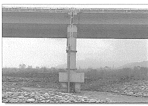
重力式壓電片沖刷監測系統
